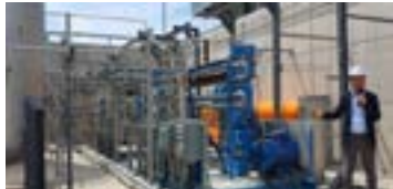
2 MW alkaline, 300 kW PEM
